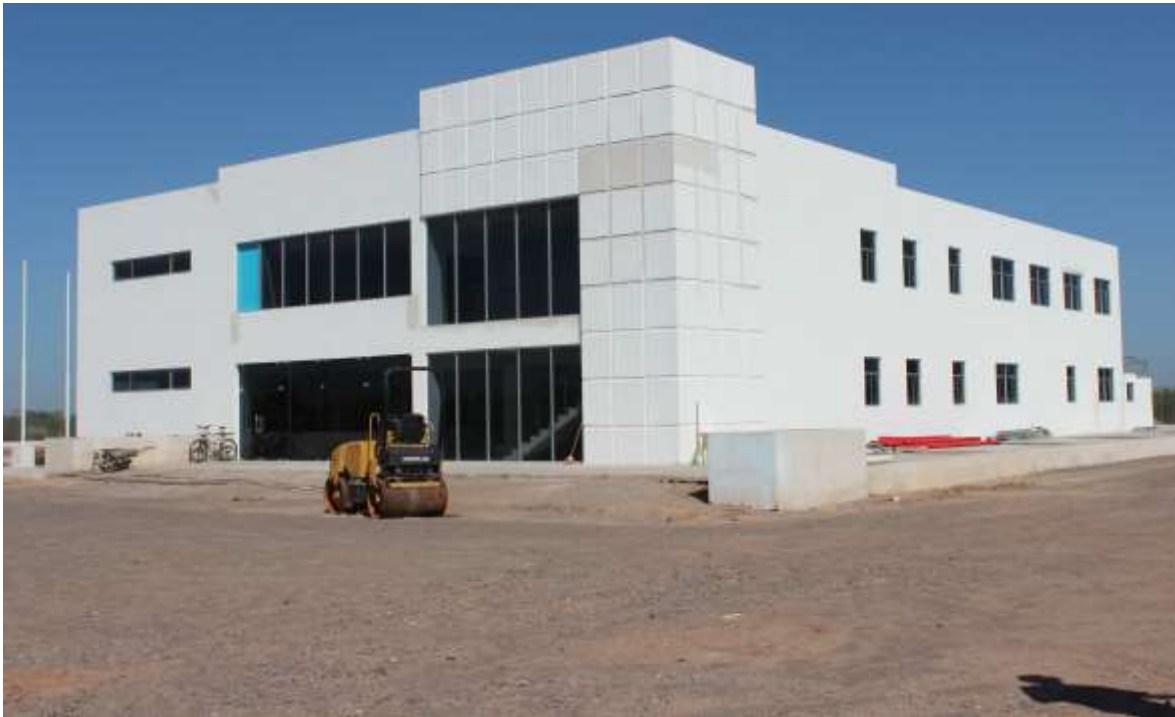
Las Obras en construcción de Juzgados en Ciudad Constitución, BCS; registran avances del 95%.
